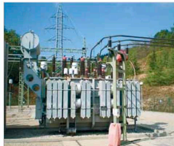
Imatge de la subestació d'Endesa a Sant Hilari, on s'ha col·locat el nou dispositiu de telecontrol ■ EL PUNT AVUI
